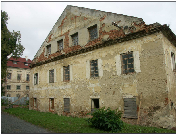
Týnec, jižní průčelí starého zámku, v pozadí nový zámek (foto J. Anderle 2005).
