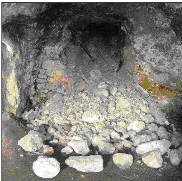
Zvířetice, starý palác – destrukce provizorní výztuže (duben 2015).
