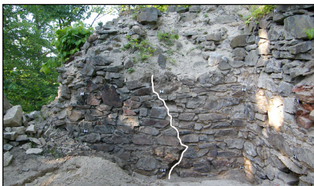
Obr. 4: Rýzmbek – zvýrazněná spára na vnitřním líci severovýchodní zdi tzv. starého paláce dokládající složitější vývoj této části dispozice. Jedná se pravděpodobně o přezděný fragment původní obvodové hradby jádra hradu – pohled od jihozápadu (foto P. Kausek 2015).
